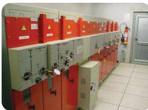
Modèle et Intérieur d'un poste de livraison
